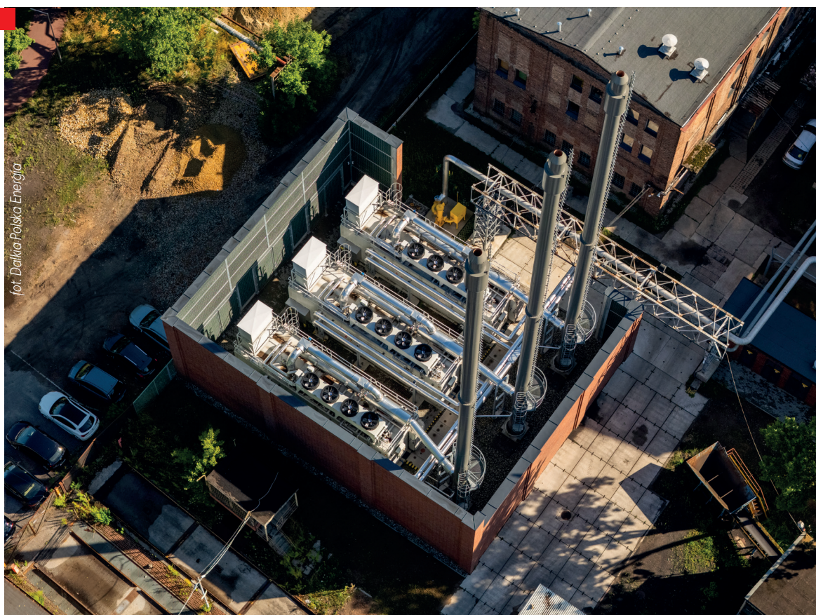
INSTALACJA KOGENERACYJNA wykorzystująca metan kopalniany na zakładzie Wieczerek
