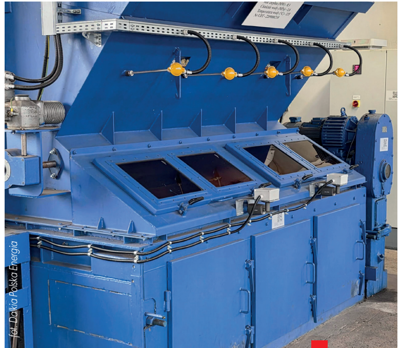
ZMODERNIZOWANY KOCIOŁ BIOMASOWY w Rudzie Śląskiej
