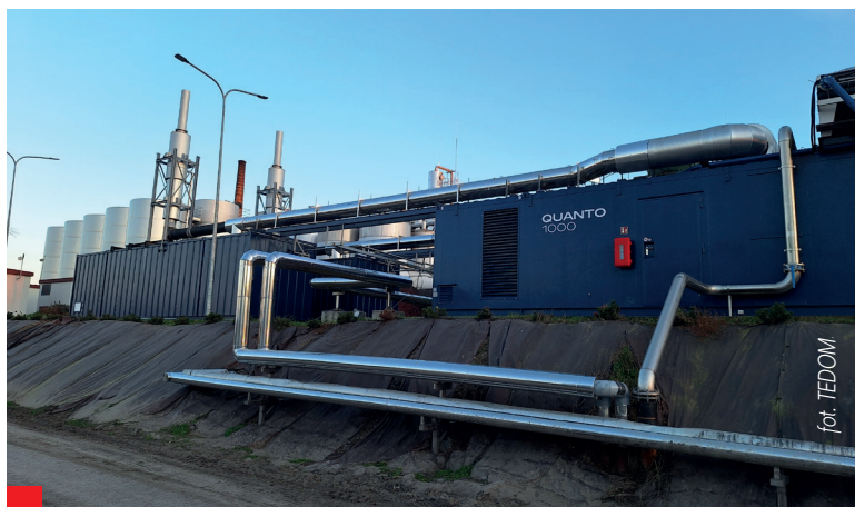
SURWIN miejscowość Suchowola – 2 x 1MW Quanto z wytwornicami pary Danstoker, na biogaz w biogazowni przy Surwin Sp. z o.o. Podlaskie Gorzelnie (w trakcie uruchamiania, model dzierżawy)
