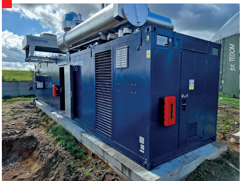
ZAWROTY – 999 kW na biogaz, drugi silnik dostarczony przez Tedom, wcześniej 499, też Quanto, uruchomienie w marcu 2026. Biogazowania Marszał w Zawrotach, województwo warmińsko-mazurskie
