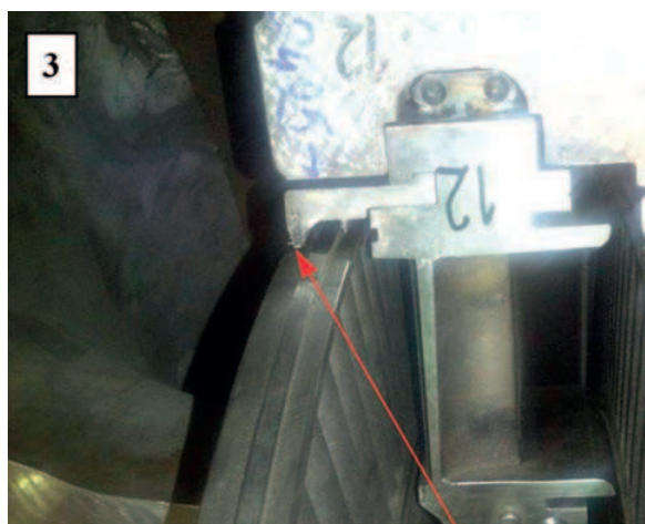
Szczotka uszczelnienia nadbandażowego zmodernizowanego stopnia WP nr 12
