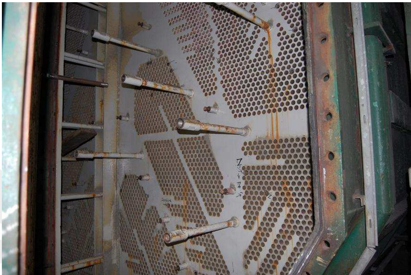
Dno sitowe z zaznaczonymi rurami do wymiany
