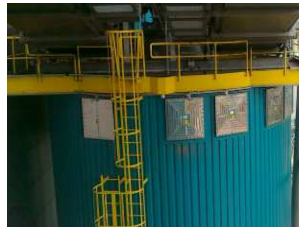
Panele eksplozyjne na zasobniku przykotłowym
