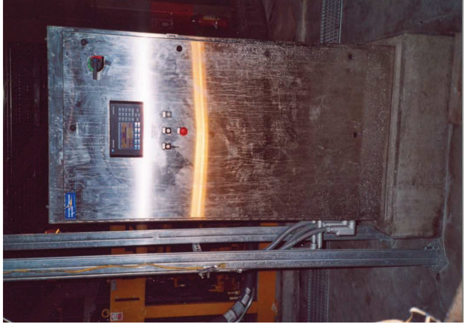
Tablica rozdzielcza z Alan Bradley PLC
