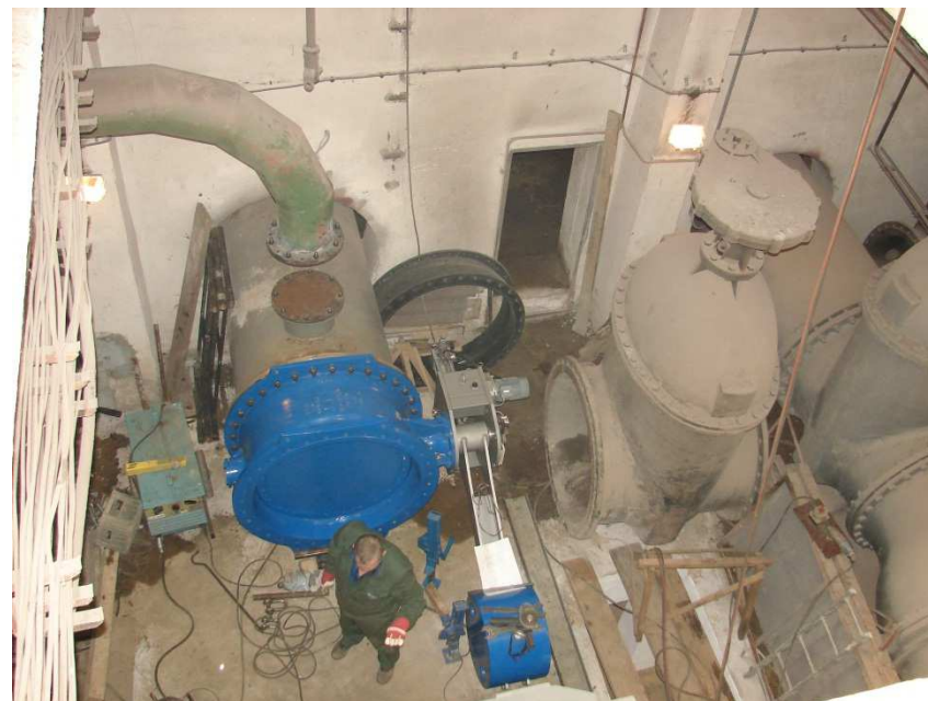
Instalacja EKN DN 1200 HB-HV
