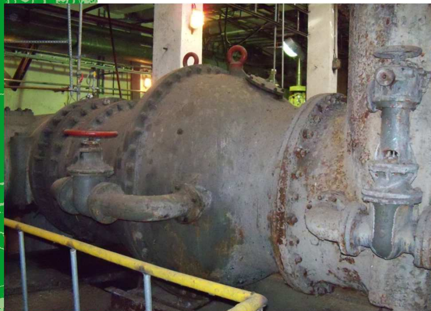
Przed modernizacją zawór wieloklapowy
