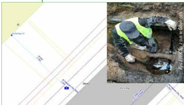
RYS. 3 Dzięki dokumentacji wprowadzonej na mapę cyfrową przedsiębiorstwa pracownicy spółki mogą w prosty sposób dotrzeć do dokumentacji źródłowej danego obiektu
